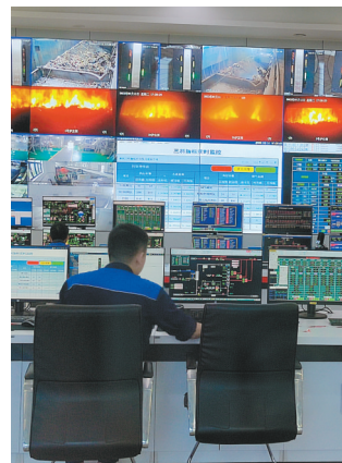
中央控制室监控着垃圾焚烧发电过程的视频和数据。
