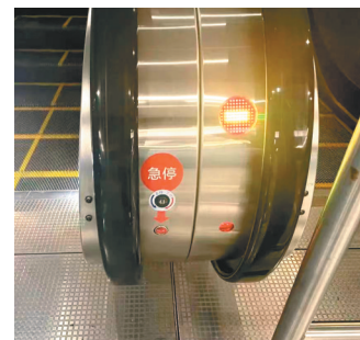
紧急停梯按钮:普通扶梯两端各一个,长扶梯除此之外在中部另设一个。
